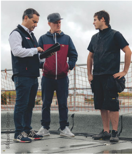
Luigi Greco (Gesacon), Philipp Niemeyer (Sema) und Spenglermeister Stefan Adelsberger erfassen beim Baustellentermin exemplarisch relevante Profile und ihre Maße am Tablet. Später werden sie am PC weiterverarbeitet.
